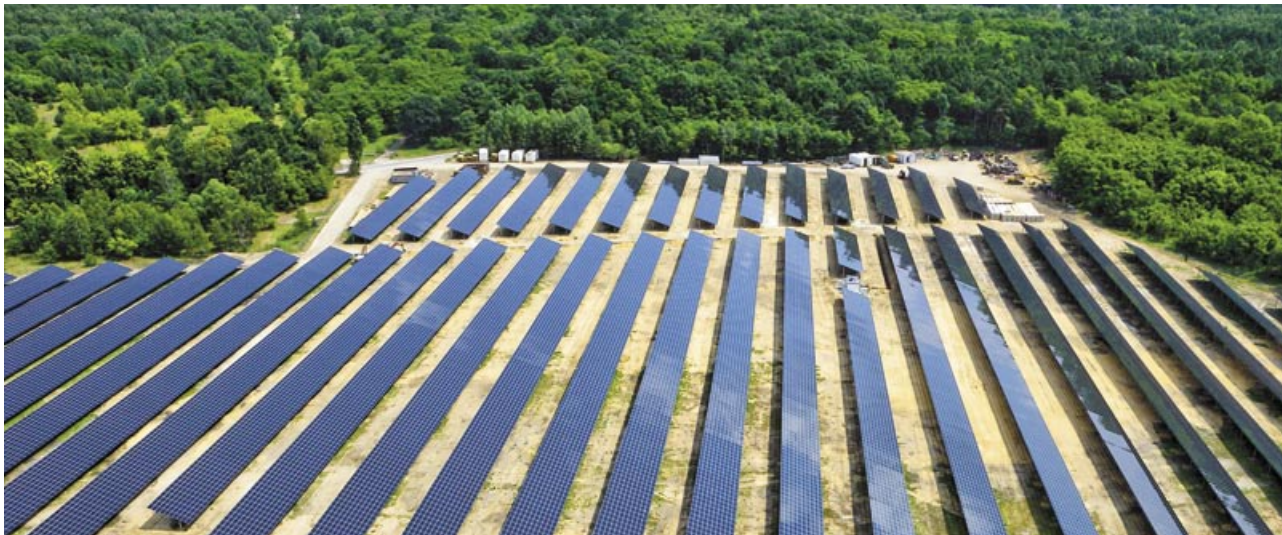
Photovoltaikkraftwerk Wünsdorf, Stand Juni 2011
