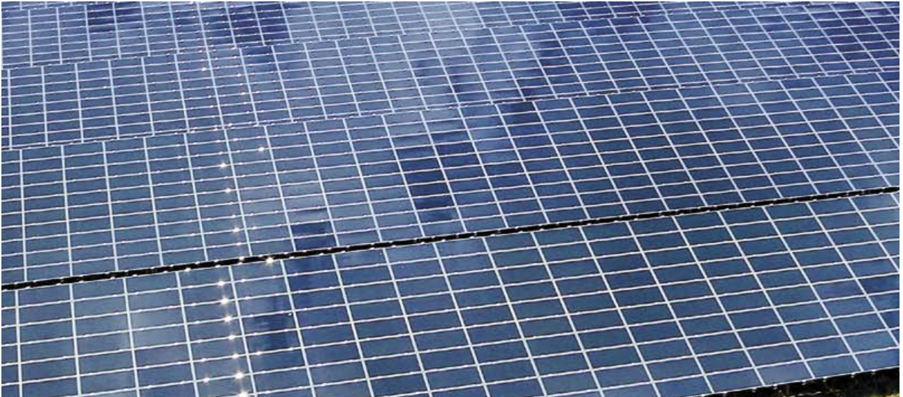
Photovoltaikkraftwerk Wünsdorf, Stand Juni 2011
