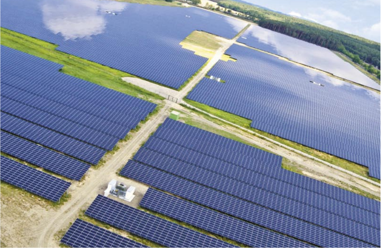
Photovoltaik-Kraftwerk Reckahn III, Stand Juni 2011
