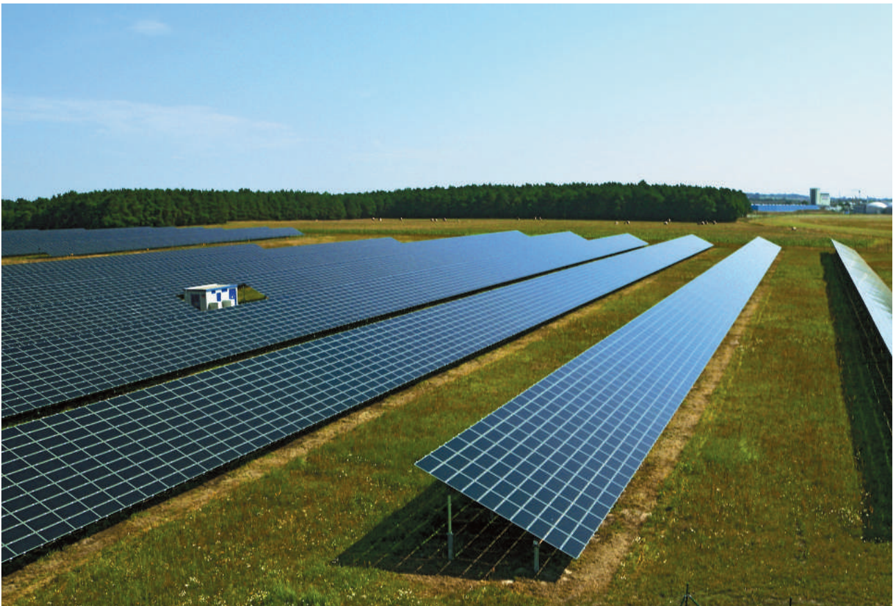
Solarkraftwerk Jessen, CFB-Fonds 174
