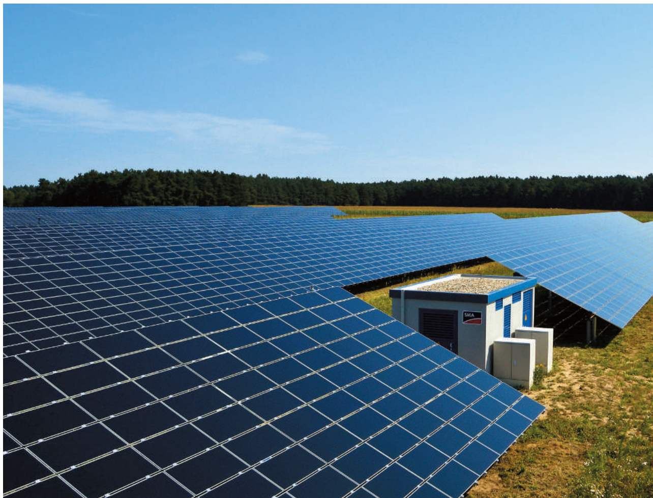
Solkraftwerk Jessen, CFB-Fonds 174
