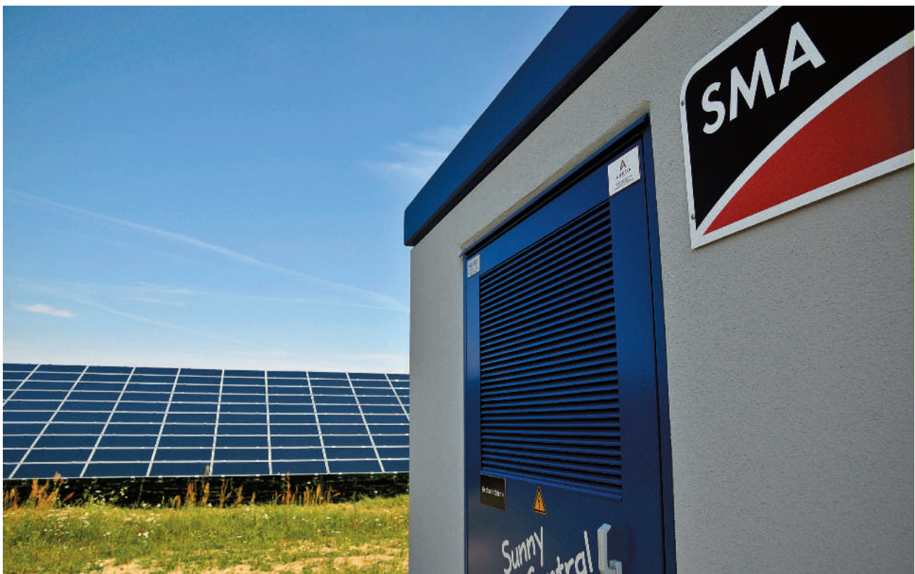
Solarkraftwerk Jessen, CFB-Fonds 174
